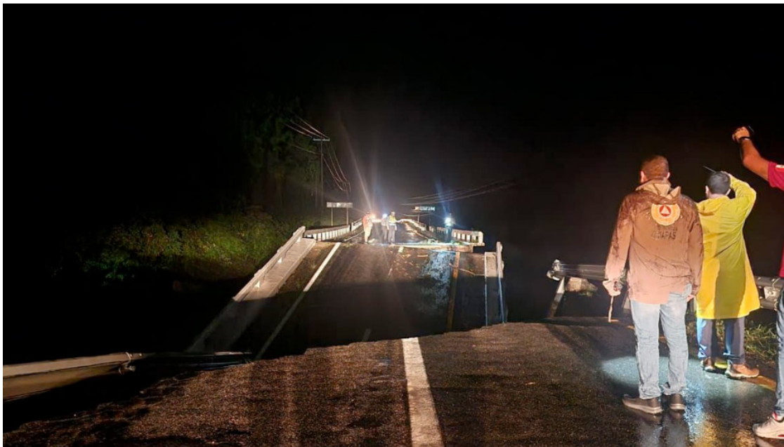
Figura 1b. Colapso del puente Tablazón I en Ulapa, Mapastepec, tras intensas lluvias (2025). Fuente: Protección Civil Chiapas.
